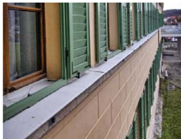
Сетевой кабель (ZA 1999 FS5) проложен по подоконникам
