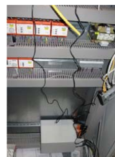
Система сбора данных ALMEMO® MA 5690 1M09 TG3, установленная на DIN-рейку в электрошкафу
