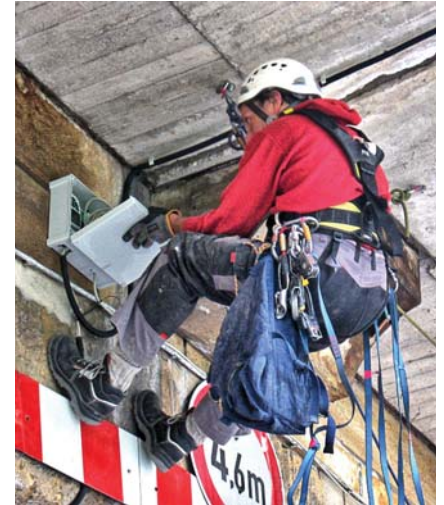
Измерительная станция, установленная под проезжей частью моста, с системой сбора данных ALMEMO® и узлами сети
