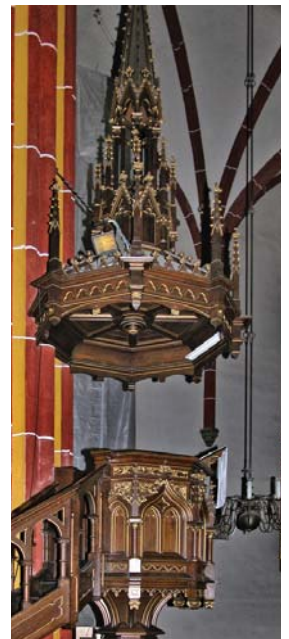
Датчик потока воздуха (термоанемометр), в районе кафедры
