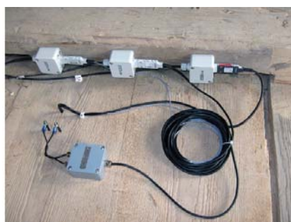
Деревянный кессонный потолок с установленными датчиками, кабель-удлиннитель и розетка
